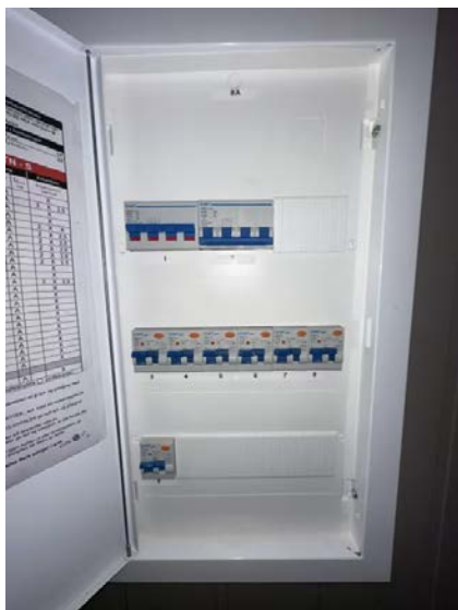
Viser innfelt sikringsskap plassert på soverom.
