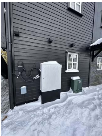
Viser utvendig inntaksskap med måler.
