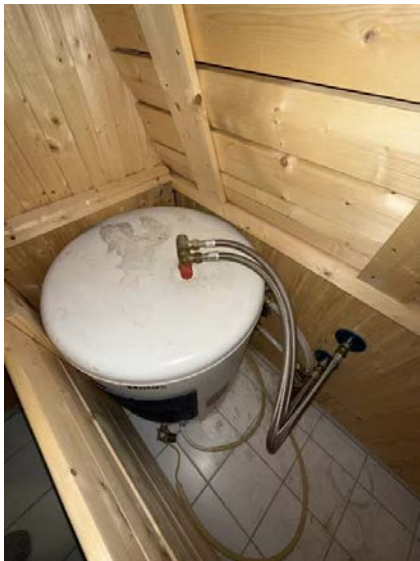
Viser bereder plassert i badstue.
