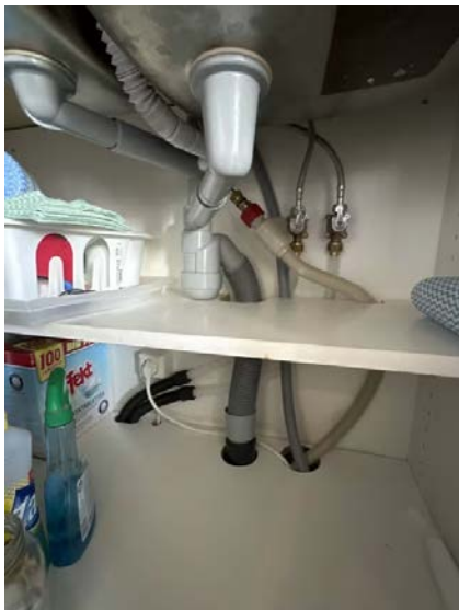
Viser vann og avløpsinnstallasjoner under kum.
