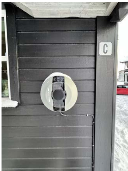
Viser elbillader montert ved inngangsparti.
