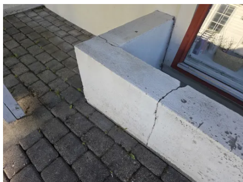
Sprekk i lysgrav.
