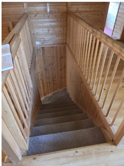
Trapp loft. Håndløpere mangler.
