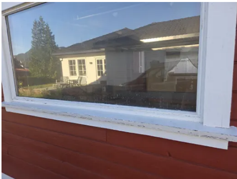
Værslitt overflate vindu.
