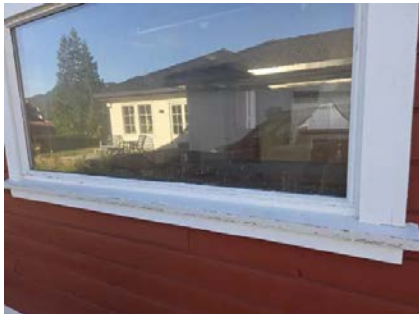
Værslitt overflate vindu.
