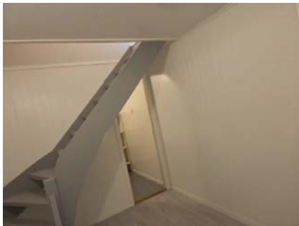
Trapp i U-etg. Rekkverk og håndløper mangler.
