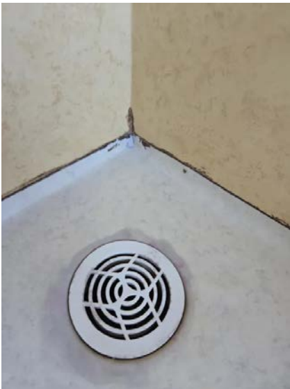
Indikasjon på fukt rundt sluk. Sprekker på tapet/belegg.
