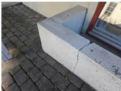
Sprekk i lysgrav.
