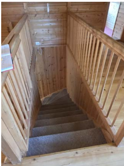
Trapp loft. Håndløpere mangler.
