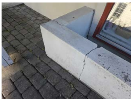
Sprekk i lysgrav.
