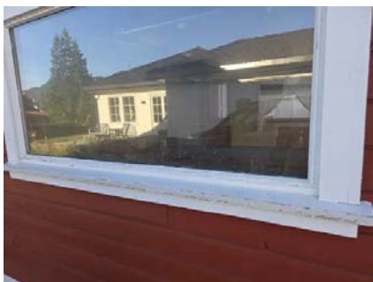
Værslitt overflate vindu.
