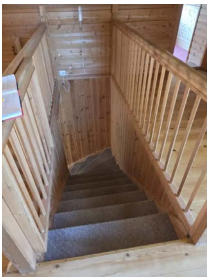
Trapp loft. Håndløpere mangler.
