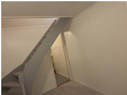
Trapp i U-etg. Rekkverk og håndløper mangler.
