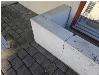
Sprekk i lysgrav.
