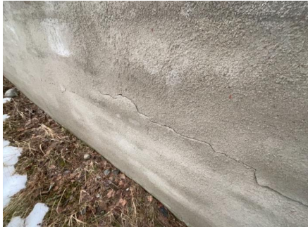
Sprekker i grunnmur.
