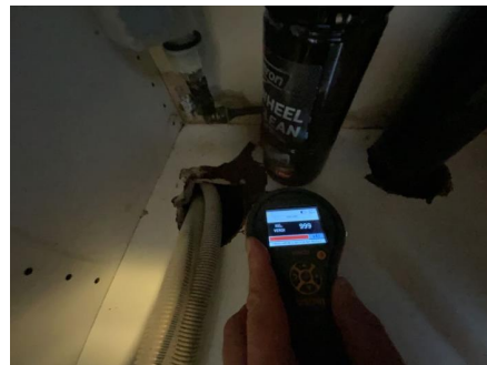
Lekkasje fra vannledning i benkeskap
