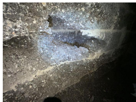
Oppsmuldring fra innvendig side av grunnmur.
