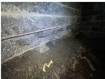
Synlig armering med korrosjon og oppsmuldring av grunnmur innvendig.
