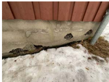
Oppsmuldring fra utvendig side av grunnmur.
