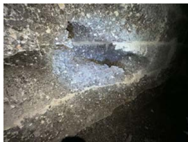
Oppsmuldring fra innvendig side av grunnmur.
