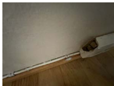
Skade på deksel i stue.
