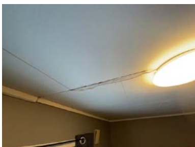
Løs kabel til taklampe.
