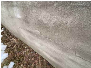
Sprekker i grunnmur.
