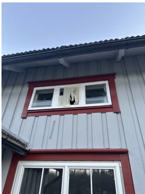
Viser knust glass på vindu i 2.etasje
