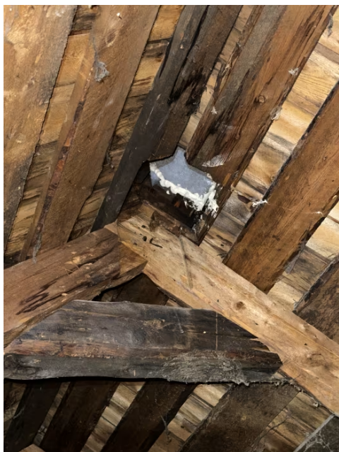
Det registreres fuktskjolder ved takkonstruksjonen. Kun besiktiget fra luke grunnet manglende adkomst.
