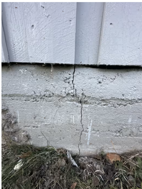
Viser sprekke i grunnmur.
