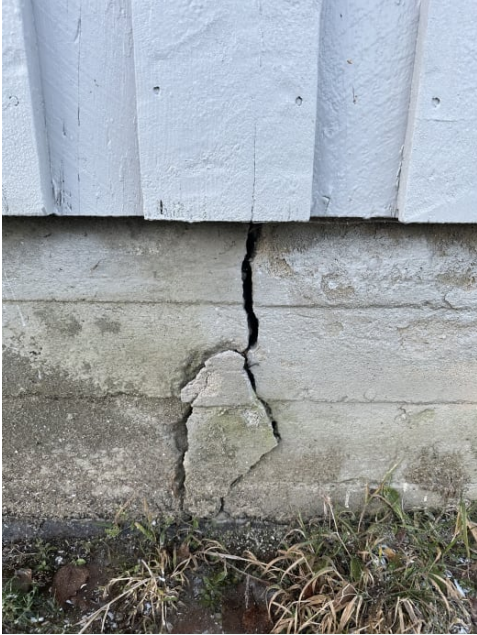
Viser sprekk i ringmur.
