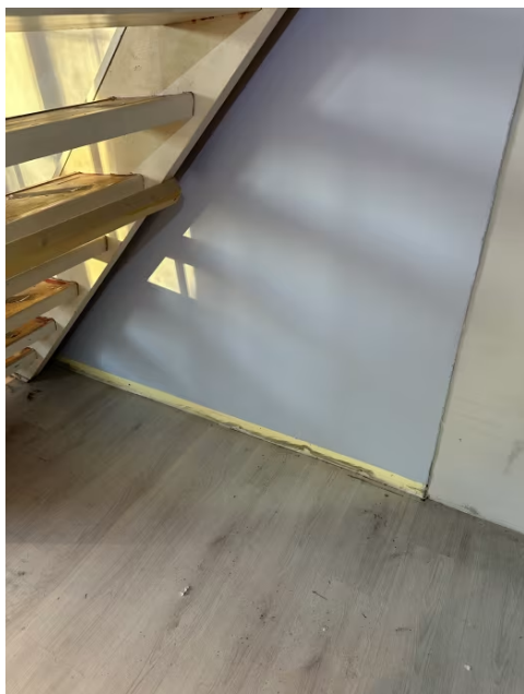
Viser eksempel på gjenstående arbeid ved overganger/avslutninger.
