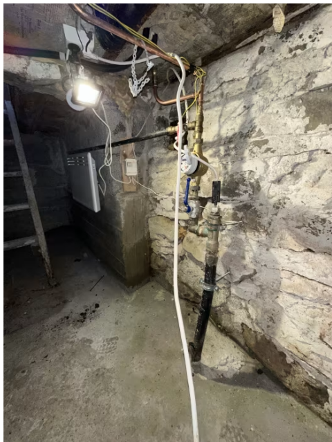
Viser vanninntak, hovedstoppekran og vannmåler i kjeller.
