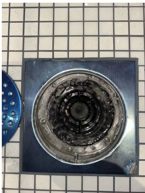
Viser sluk i dusjsonen.
