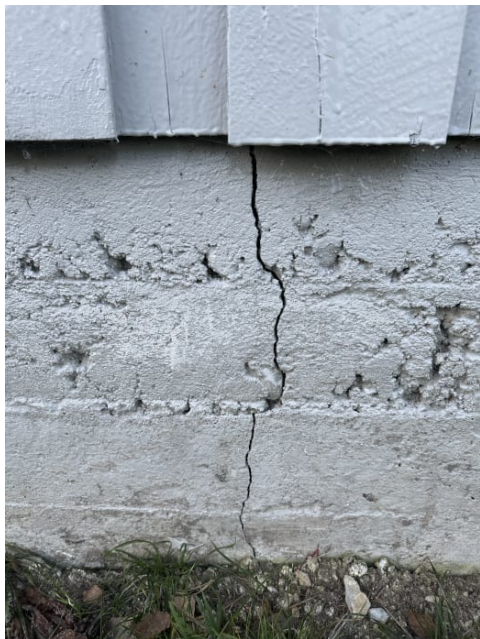
Viser sprekk i grunnmur.
