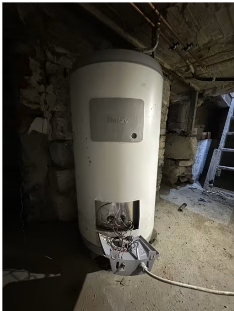
Viser bereder plassert i kjeller. Lokk på bereder er ikke festet.
