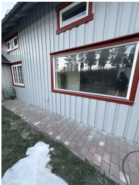
Bordkledningen er avsluttet for nærme bakken med påfølgende fare for nedfukning og skader over tid. et er ikke mulig å kontrollere lufting mellom kledning og veggkonstruksjon ved terrasse og ved belegningsstein.
