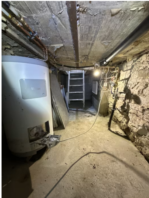
Viser grovkjeller. Etablert varmtvannsbereeder, vanninntak, hovedstoppekran og vannmåler. Oppvarming med panelovn.
