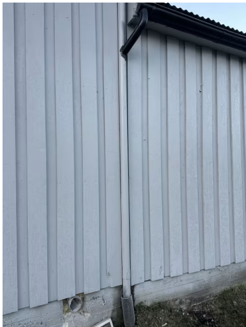
Deler av nedløpsrør er ført videre til nedgravd drensør.
