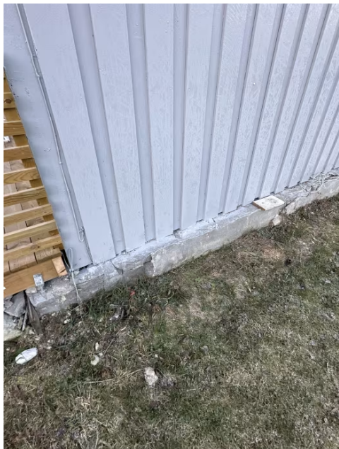
Viser avskalling på grunnmur.
