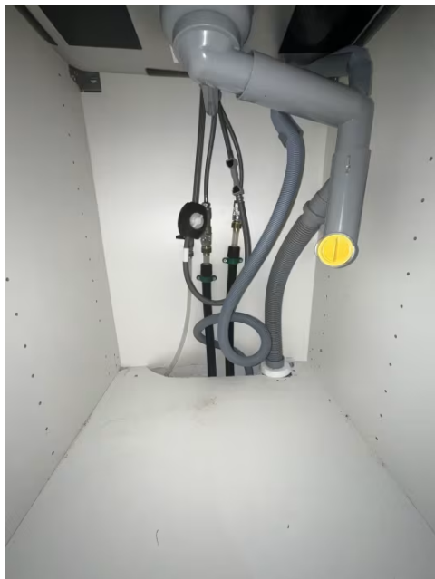
Viser vann og avløps installasjoner under kum.
