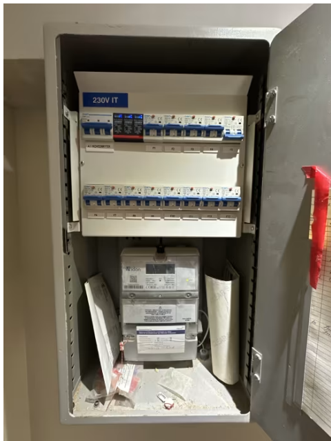
Viser sikringskap plassert i 2.etasje.
