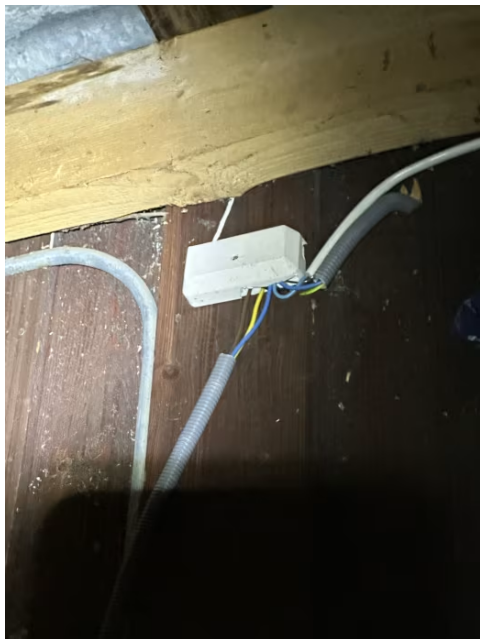
Viser koblingsboks i garasje med ufagmessig utførelse.
