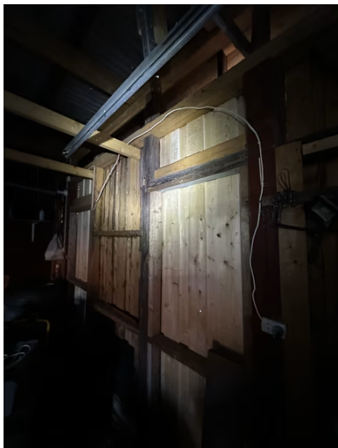
Det registreres løse strømkabler i garasje.
