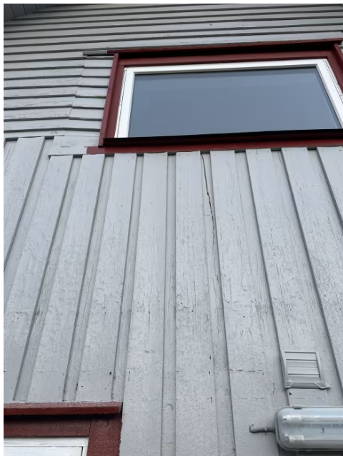
Viser slitasje og sprekker i yttervegg mot sør.
