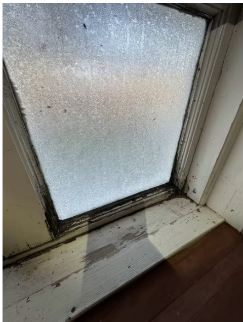
Det registreres råteskader i karmen på de eldste vinduer med enkle glass.
