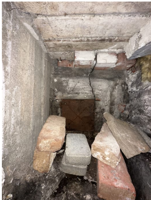
Viser sotluke i kjeller. Defekt sotluke i bunn av skorstein. Sotluke må skiftes.
