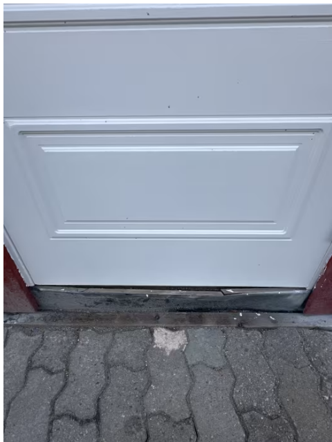
Viser defekt beslag og mindre skade under inngangsdør.
