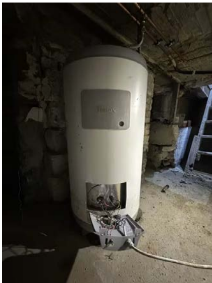
Viser bereder plassert i kjeller. Lukk på bereder er ikke festet.
