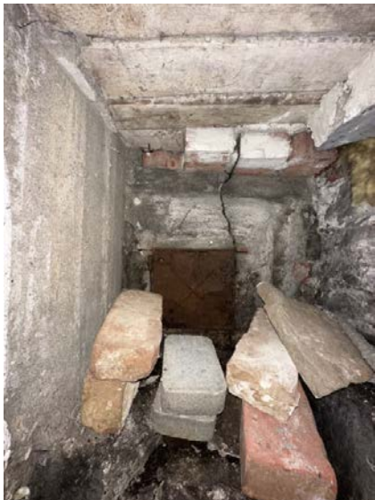
Viser sotluke i kjeller. Defekt sotluke i bunn av skorstein. Sotluke må skiftes.
