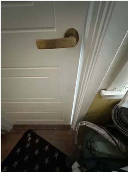
Viser glippe mellom karm og ytterdør. Ytterdør tetter ikke.
