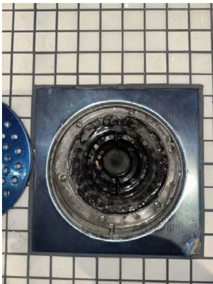
Viser sluk i dusjsonen.
