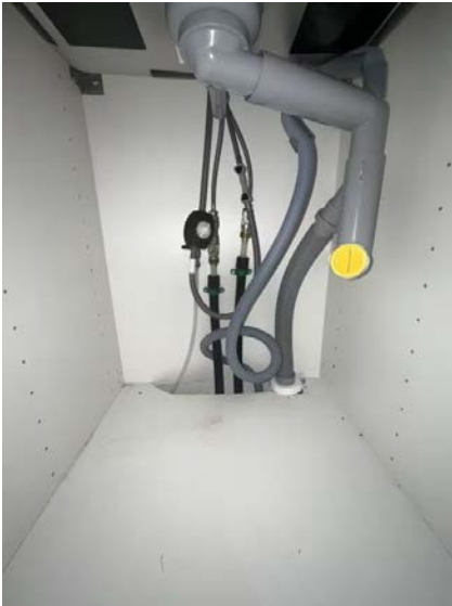
Viser vann og avløps installasjoner under kum.
