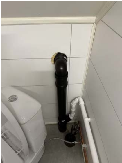
Viser mulig lufting av avløpsanlegg ført ut gjennom yttervegg. Anbefaler ytterligere undersøkelser.
