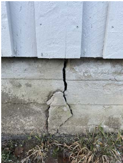
Viser sprekk i ringmur.
