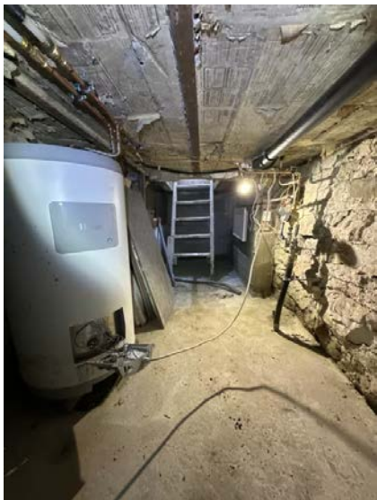
Viser grovkjeller. Etablert varmtvannsbereder, vanninntak, hovedstoppekran og vannmåler. Oppvarming med panelovn.
