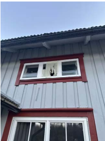
Viser knust glass på vindu i 2.etasje
