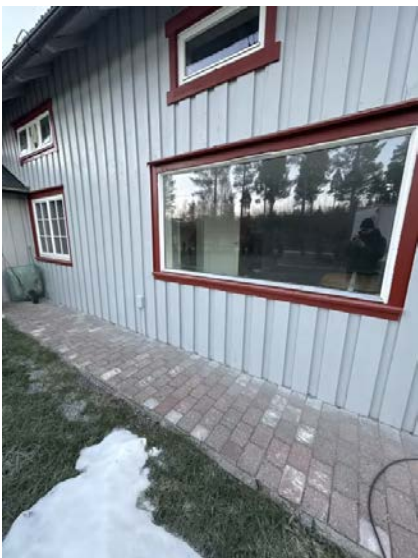
Bordkledningen er avsluttet for nærme bakken med påfølgende fare for nedfukning og skader over tid. et er ikke mulig å kontrollere lufting mellom kledning og veggkonstruksjon ved terrasse og ved belegningsstein.
