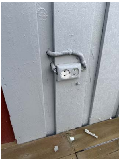
Viser ujordet stikkontakt utvendig som ikke beregnet for utvendig montering. Kabler er avslutet ufagmessig.
