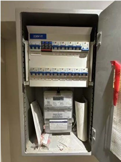
Viser sikringsskap plassert i 2.etasje.
