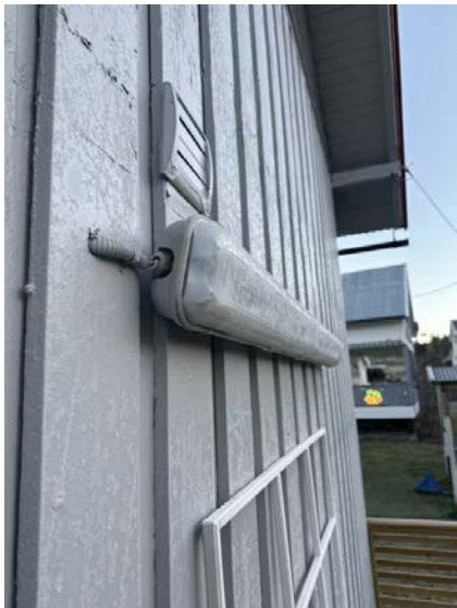
Viser lampe ved terrasse. Kabler er ikke avsluttet fagmessig.
