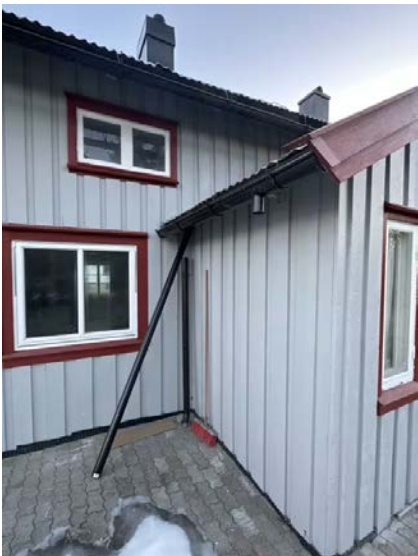
Takrenne ved inngangsparti er ikke ferdigstilt.
