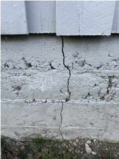
Viser sprekk i grunnmur.
