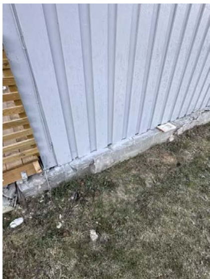
Viser avskalling på grunnmur.
