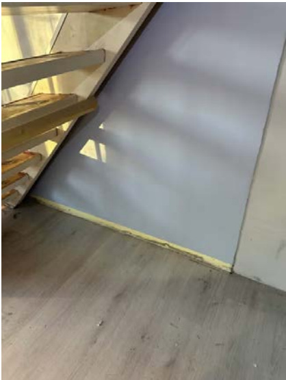
Viser eksempel på gjenstående arbeid ved overganger/avslutninger.
