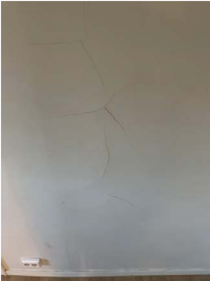
Viser sprekke i kledning rundt pipa i 2.etasje. Anbefaler ytterligere undersøkelser.
