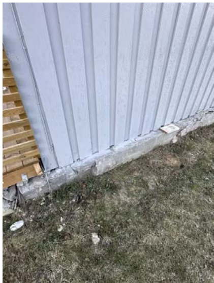
Viser avskalling på grunnmur.
