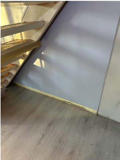
Viser eksempel på gjenstående arbeid ved overganger/avslutninger.
