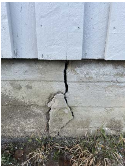
Viser sprekk i ringmur.
