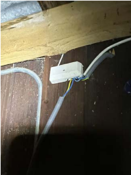
Viser koblingsboks i garasje med ufagmessig utførelse.
