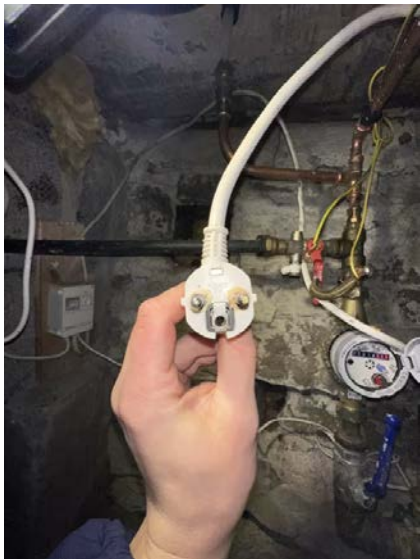
Støpsel er brunsvidd pga varmgang
