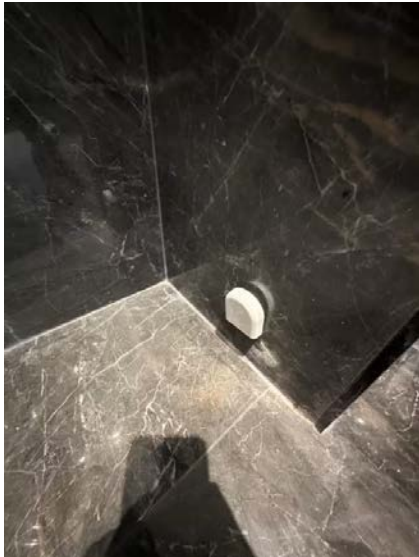
Viser avrenning fra fordelerskap.
