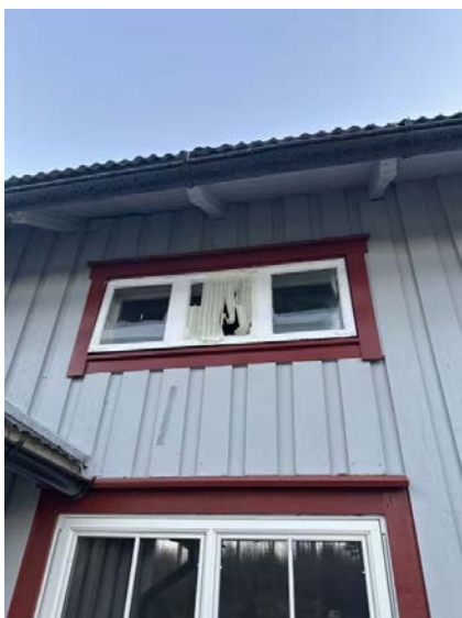
Viser knust glass på vindu i 2.etasje
