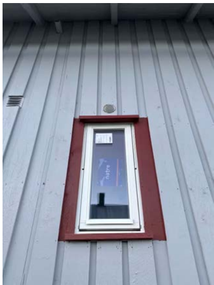
Ventil mangler utvendig på avtrekk.
