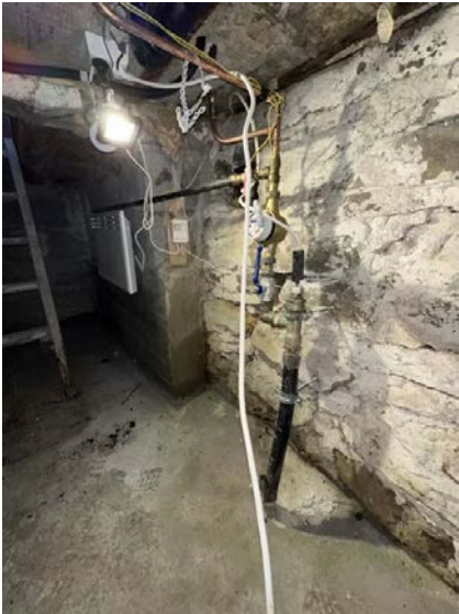
Viser vanninntak, hovedstoppekran og vannmåler i kjeller.
