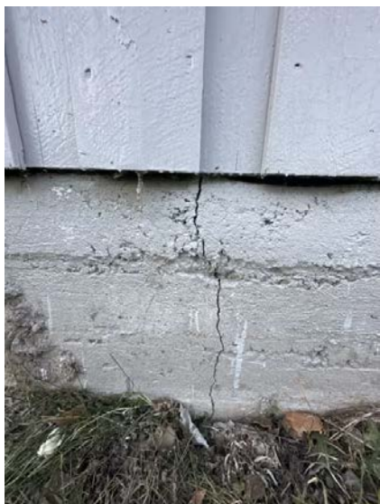
Viser sprekk i grunnmur.
