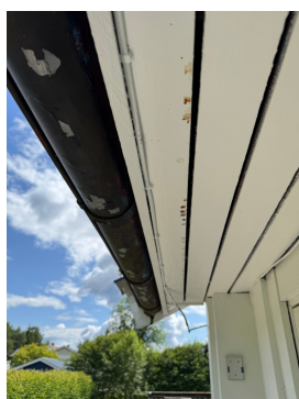
Fuktskader og merker i gesimskasse etter lekkasje.
