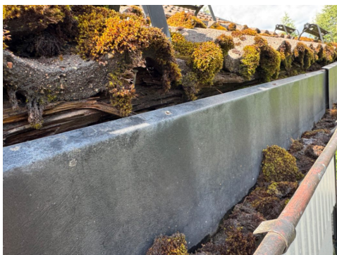
Fukt- og råteskadet steinlekt.
