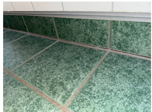
Sprekker i silikonfuger.
