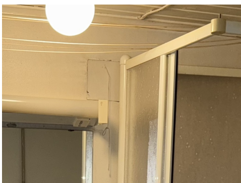
Naturlig ventilasjon via veggventil
