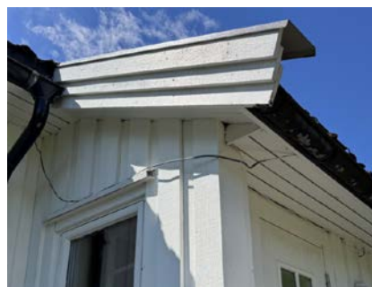
Løse kabler med ukjent funksjon
