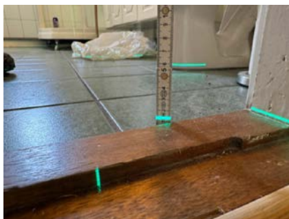
Gulv ved terskel 15mm (fall 14mm)
