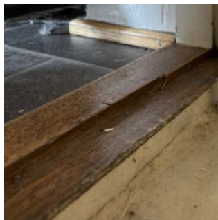
Liten tilluftspalte i terskel
