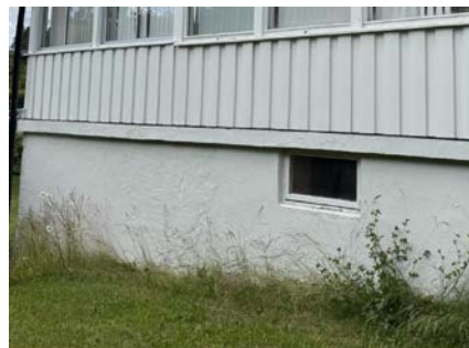
Ingen påvist fukt- grunnmurs
