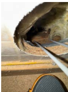
Synlig fukt- og påbegynt råteskadet svill samt plast i vegg.
