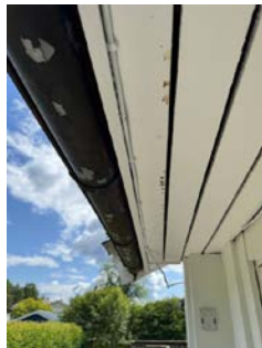
Fuktskader og merker i gesimskasse etter lekkasje.
