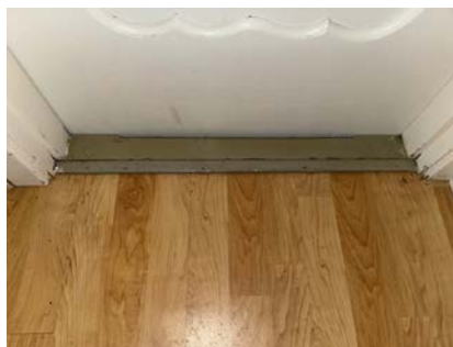
Liten/tett tilluftsspalte under dør.
