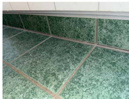
Sprekker i silikonfuger.
