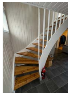
Trappeløp uten håndlister og avstand på ca 12 cm mellom spiler
