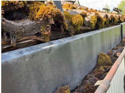
Fukt- og råteskadet steinlekt.
