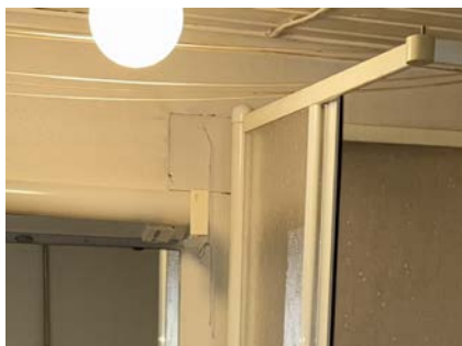
Naturlig ventilasjon via veggventil
