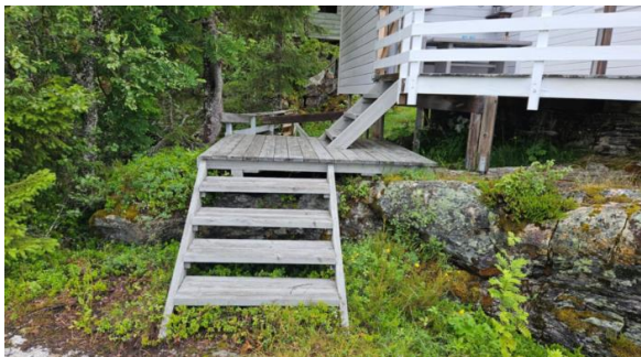
Trapp ned mot sjøen mangler rekkverk.
