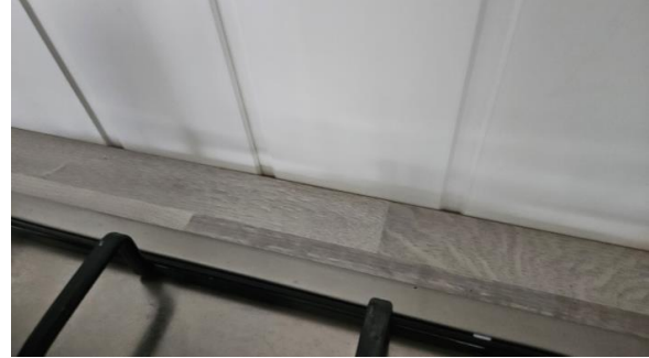
Det er ikke fuget mellom benkeplate og vegg.
