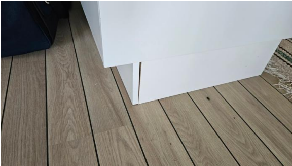
Sokkel er ikke tilstrekkelig festet.
