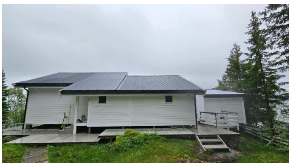
Trapp mot utedo mangler rekkverk.
