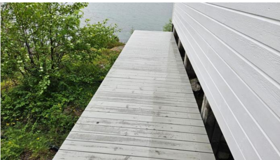
Det er ikke montert rekkverk på terrasse ved fasade nord-øst.
