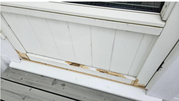
Fuktsvell utvendig på balkongdør.
