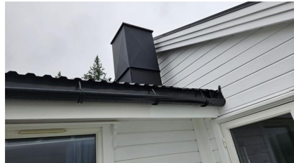
Pipe står mot tilbygd del. Høyden på pipen er for lav.
