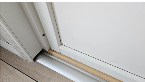
Fuktsvell innvendig på balkongdør.
