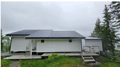
Trapp mot utedo mangler rekkverk.
