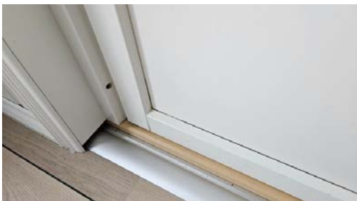
Fuktsvell innvendig på balkongdør.
