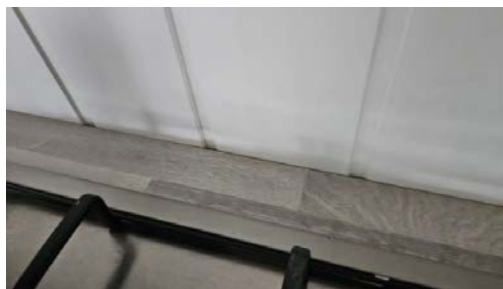
Det er ikke fuget mellom benkeplate og vegg.
