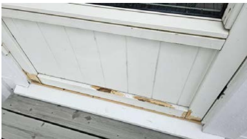
Fuktsvell utvendig på balkongdør.
