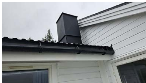
Pipe står mot tilbygd del. Høyden på pipen er for lav.
