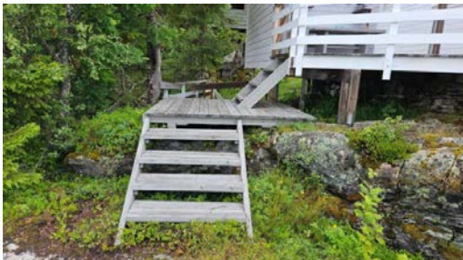
Trapp ned mot sjøen mangler rekkverk.
