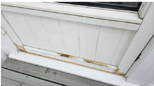
Fuktsvell utvendig på balkongdør.
