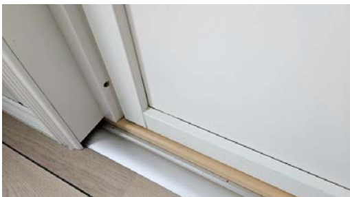
Fuktsvell innvendig på balkongdør.
