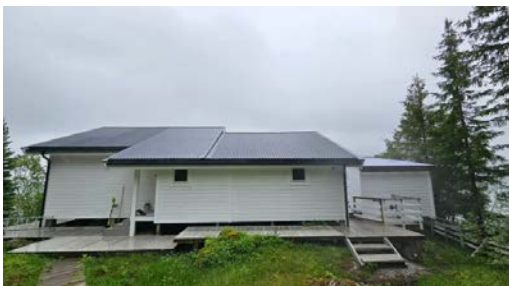
Trapp mot utedo mangler rekkverk.
