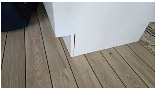
Sokkel er ikke tilstrekkelig festet.
