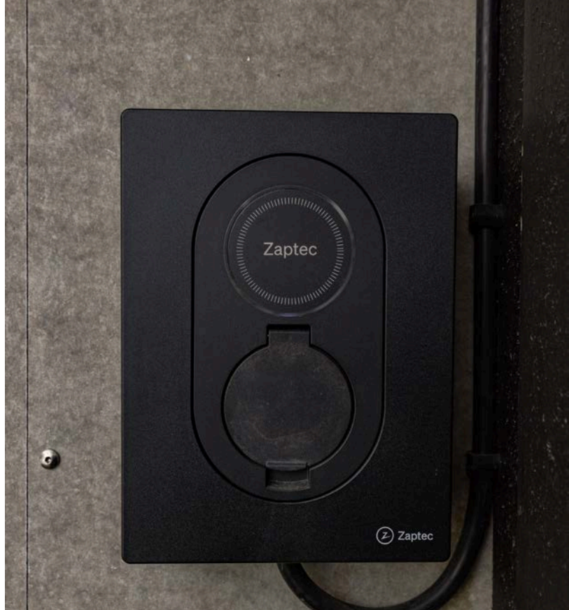
Det er montert Zaptec-lader i tilknytning carporten.
