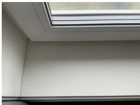
Mindre sprekk og skjolder på utforing på soverom. Ikke målt forhøyde verdier.
