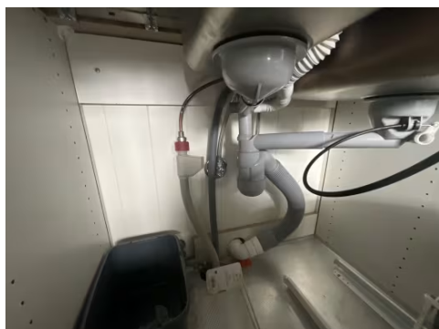
Viser vann og avløpsinnstallasjoner under kum.
