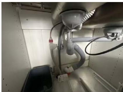
Viser vann og avløpsinnstallasjoner under kum.
