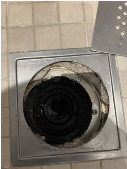
Membran er synlig ført under klemring i sluk i dusj.
