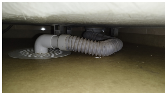
Sluk under dusjkabinettet.
