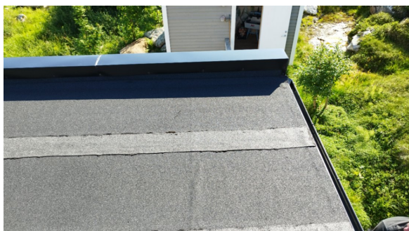
Området hvor lekkasjen oppsto.
