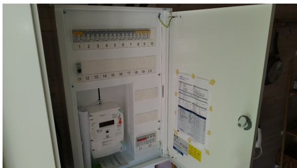
Kontroll av sikringsskapet.
