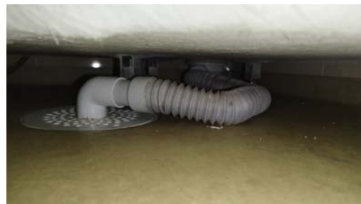
Sluk under dusjkabinettet.
