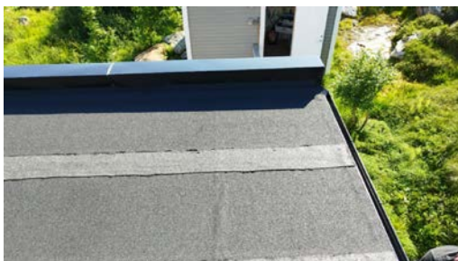
Området hvor lekkasjen oppsto.
