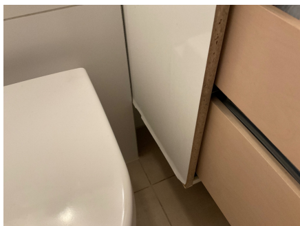
Fukskade på baderomsinnredningen.
