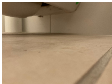
Manglende dressjakke under klosett.
