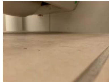
Manglende dressjakke under klosett.
