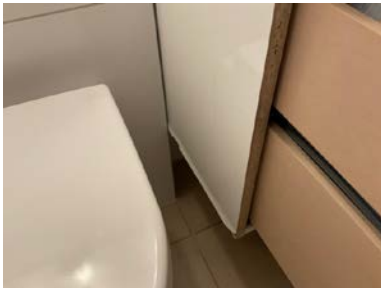
Fuktskade på baderomsinnredningen.
