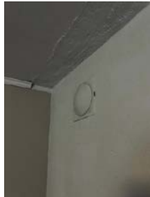
Avtreksventil i soverom i kjeller
