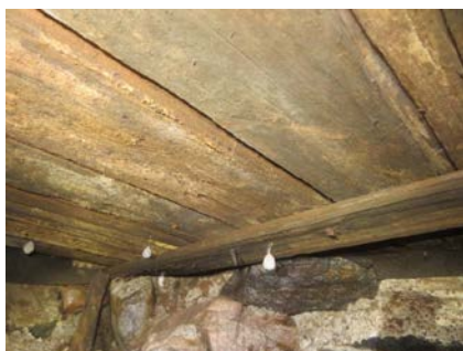
Krypkjeller med fuktinnsig og råteskader i bjelkelag.
