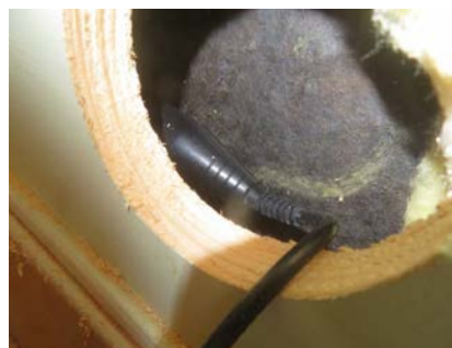
Svartapp på innforet murvegg i kjeller.
