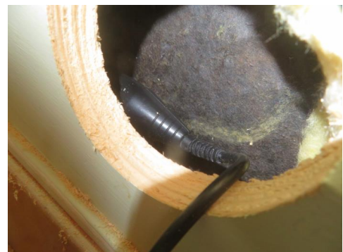
Svartpapp på innforet murvegg i kjeller.
