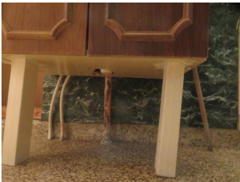
Skader på innredning.
