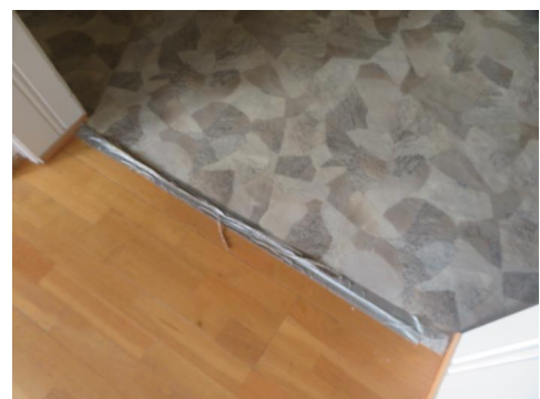
Tape i overgang i gulv mellom to rom i 1. etg.
