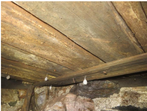
Krypkjeller med fuktinnsig og råteskader i bjelkelag.
