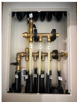
Samleskap med rørkurser og stoppekraner
