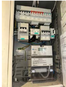
Sikringsskap med automatsikringer.
