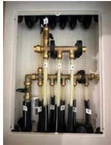
Samleskap med rørkurser og stoppekraner
