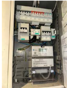
Sikringsskap med automatsikringer.
