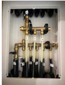
Samleskap med rørkurser og stoppekraner
