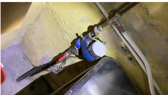
Hovedstoppekran er plassert i kjeller
