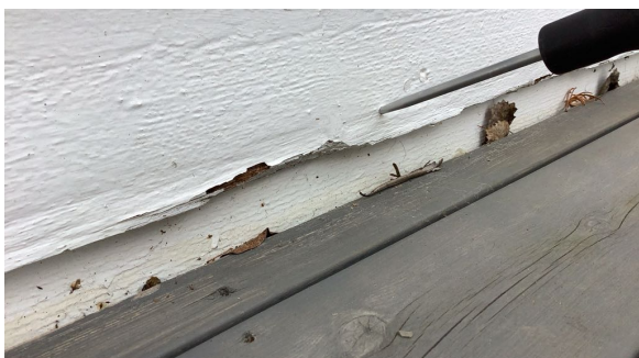
Det er enkelte råteskader på kledning over tram ved inngang. Det er avskalling av puss på kjellervegg.
