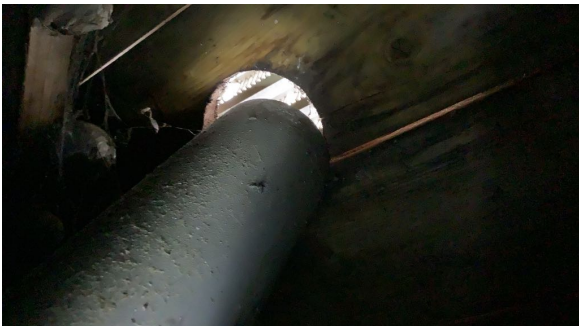
Lufterør fra kloakklufting er ført ut til vegg. Dette anbefales lagt over tak.
