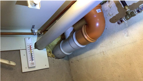
Avløpsrør av plast/PVC. Det er eldre støpejernssluk i kjellergulv og på bad i 1. etasje.
