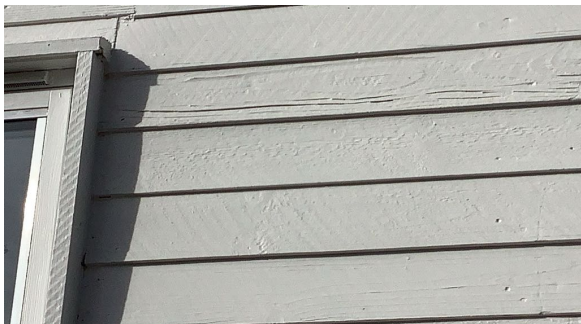
Vegg mot sør har vedlikeholdsbehov.
