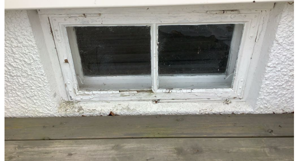
Eldre koblede vinduer i kjeller.
