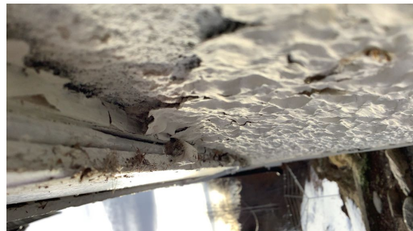
Det er ingen lufting bak kledning.
