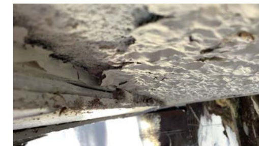
Det er ingen lufting bak kledning.
