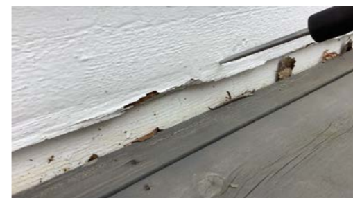
Det er enkelte råteskader på kledning over tram ved inngang. Det er avskalling av puss på kjellervegg.
