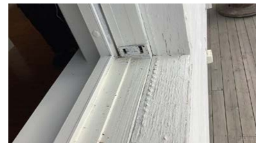
Vannbrett er plassert eil på vinduer. Vann kan renne inn i vegg.
