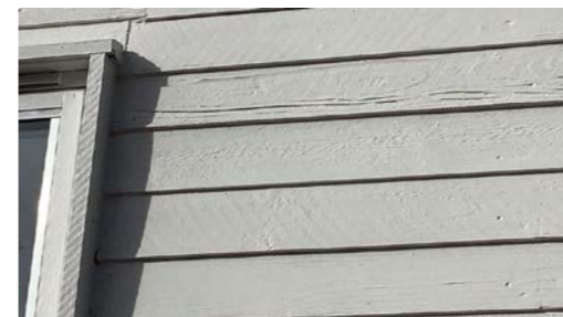
Vegg mot sør har vedlikeholdsbehov.
