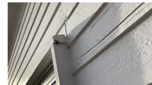
Vannbrett over vinduer er satt inntil kledning. Det mangler beslag inn bak kledning.
