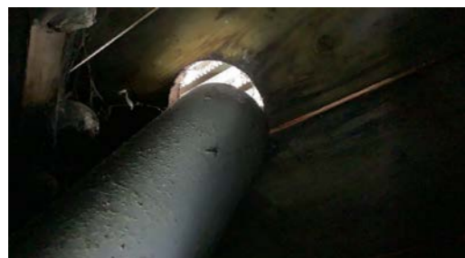
Lufterør fra kloakklufting er ført ut til vegg. Dette anbefales lagt over tak.
