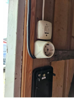
Kontakt med skjøteledning, ødelagt bryter. Garasje
