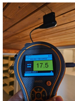
fuktmåling av treverk i himling. Fuktig/risiko.
