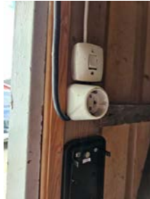
Kontakt med skjøteledning, ødelagt bryter. Garasje.
