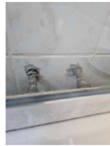
Røregjennomføringer i dusjsone.
