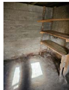
Fuktmerker i overgang vegg/gulv.
