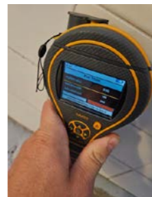
Fuktsøk på vegg indikerer at konstruksjonen er fuktig
