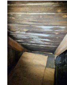
Kondensskade over trappeløp.
