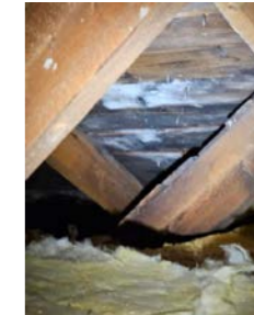
Kondensskade på takutstikk over bad.
