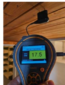
fuktmåling av treverk i himling. Fuktig/risiko.
