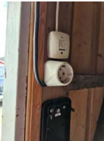
Kontakt med skjøteledning, ødelagt bryter. Garasje
