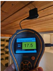
fuktmåling av treverk i himling. Fuktig/risiko.
