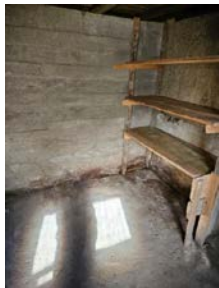
Fuktmerker i overgang vegg/gulv.
