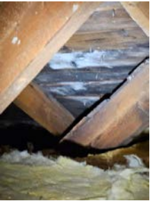
Kondensskade på takutstikk over bad.
