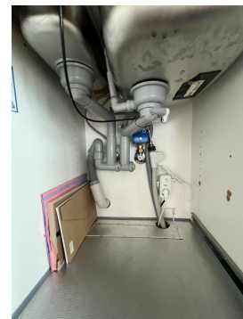
Rørpropp under kjøkkenbenk
