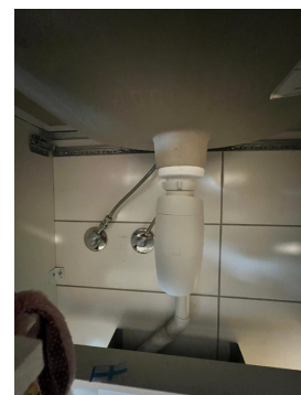
Rørpropp under vask på bad.
