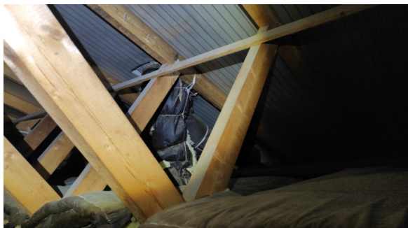
Utett gjennomføring i undertak.
