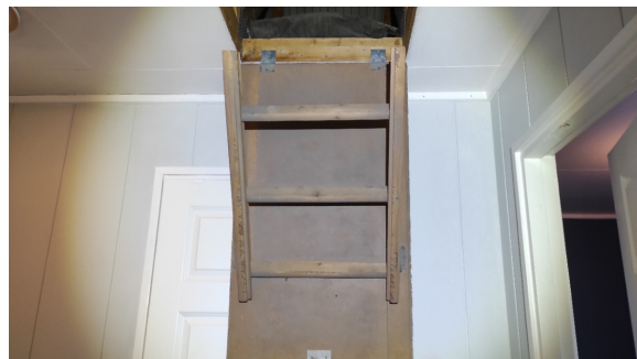
Store deler av stigen mangler.
