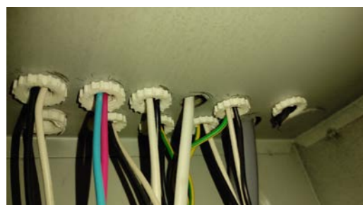
Utett gjennomføring i sikringskap.
