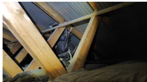
Utett gjennomføring i undertak.
