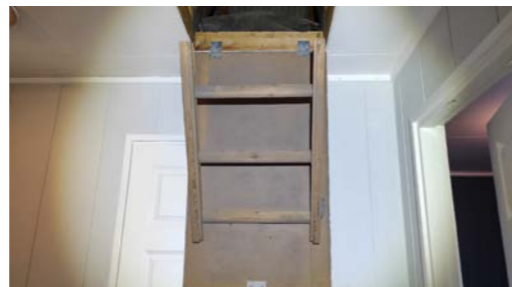
Store deler av stigen mangler.
