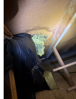
Fuktskjolder ved gjennomføring
