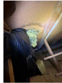
Fuktskjolder ved gjennomføring
