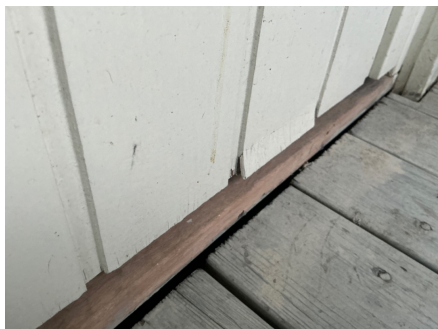
Finer på terrasse-dør er løsnet.
