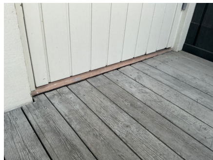
Beslag ved terskel til terrasse-dør er ikke montert.
