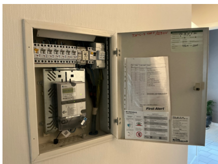
Sikringsskap står i gang.
