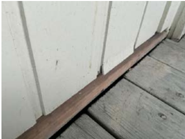
Finer på terrasse-dør er løsnet.
