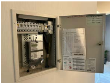
Sikringsskap står i gang.
