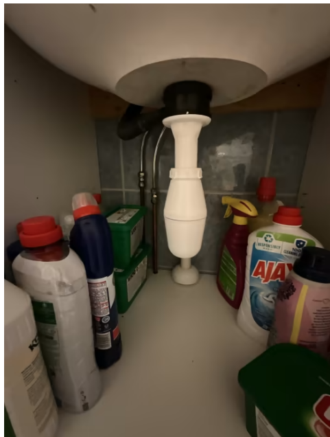
Vann - avløpsinstallasjoner under vask.
