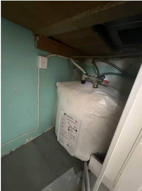
Varmtvannsbereder plasser i hjørne på kjøkken.
