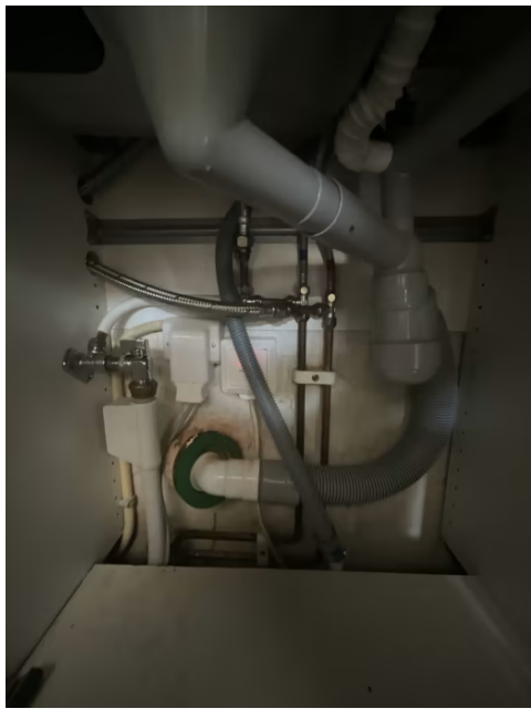
Viser vann - avløpsinstallasjoner under kum.
