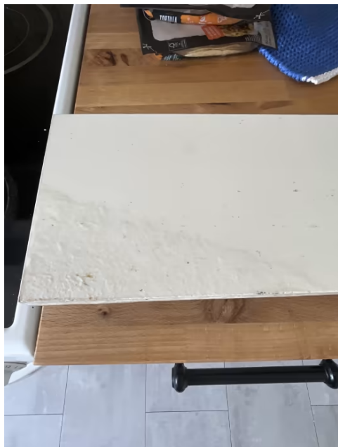
Sokkel utsatt for fukt. Tørt på befaringen.
