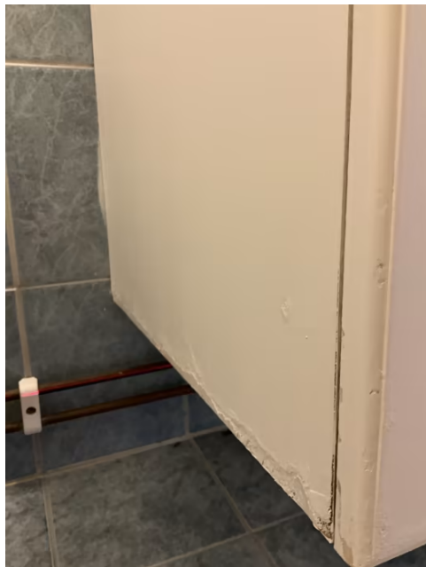
Viser baderomsinnredning utsatt for fukt.
