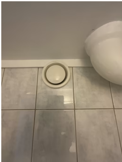
Viser avtrekk på bad.
