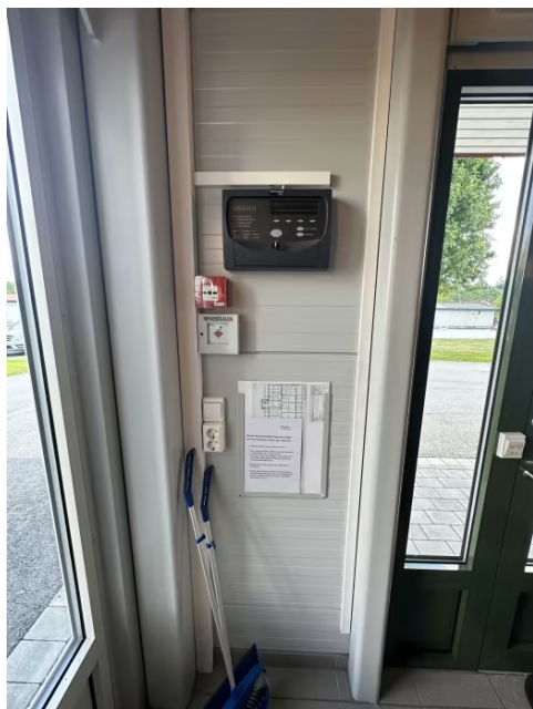
Viser brannsentral i trappehus med mulighet for å avstille.
