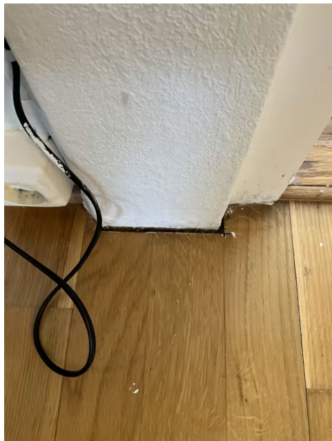
Viser glippe mellom gulv og vegg.
