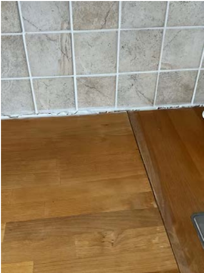
Viser sprekker i fuge mellom benkeplate og vegg.
