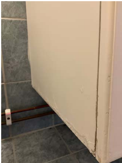
Viser baderomsinnredning utsatt for fukt.
