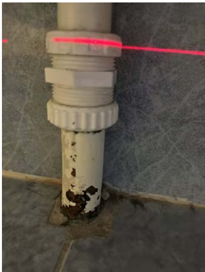
Viser svekkelser i gulvets tetthet. Ingen silikon eller mansjett rundt rør.
