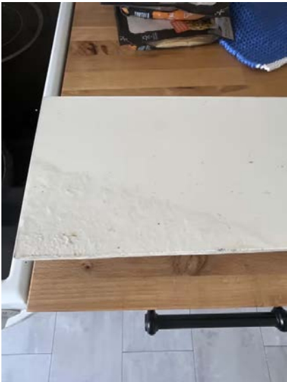
Sokkel utsatt for fukt. Tørt på befaringen.
