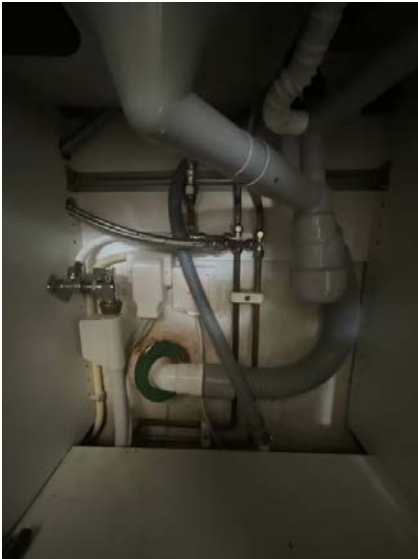
Viser vann - avløpsinstallasjoner under kum.
