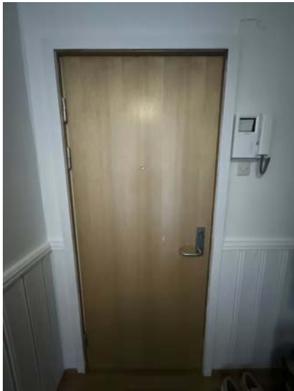
Brann og lydklassifisert ytterdør med kikkehull. Inngangsdør til blokk tilknyttet porttelefon.
