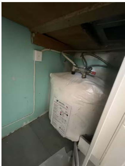
Varmtvannsbereder plasser i hjørne på kjøkken.
