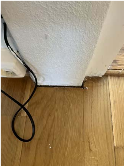
Viser glippe mellom gulv og vegg.
