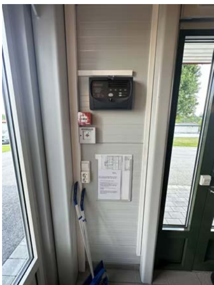
Viser brannsentral i trappeløp med mulighet for å avstille.
