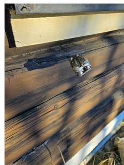
påbegynnende råteskade i stokk.
