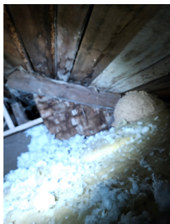
Fuktmerke i treverk rundt pipe.
