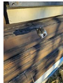
påbegynnende råteskade i stokk.
