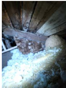
Fuktmerke i treverk rundt pipe.
