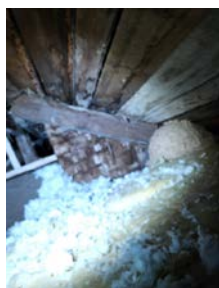
Fuktmerke i treverk rundt pipe.
