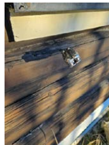
påbegynnende råteskade i stokk.
