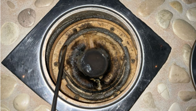
Plastsluk i gulv.
