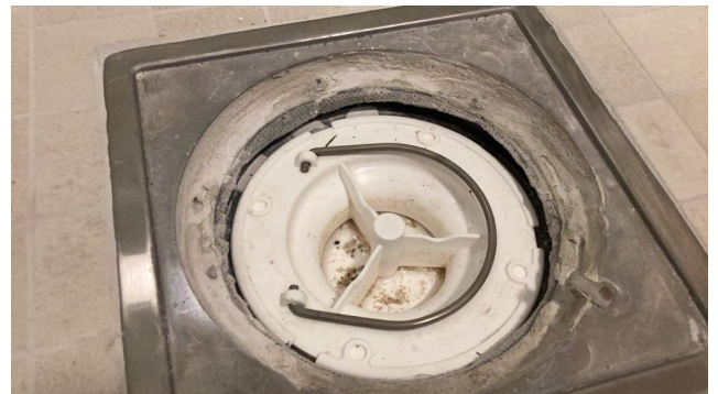
Viser sluk i dusjsonen
