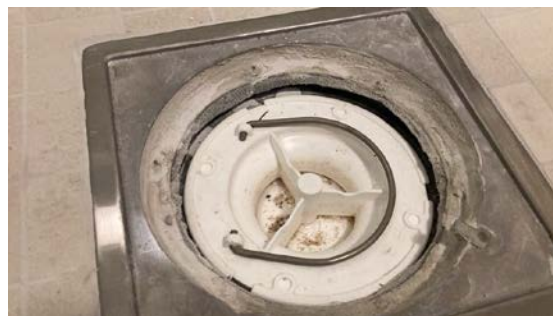
Viser sluk i dusjsonen
