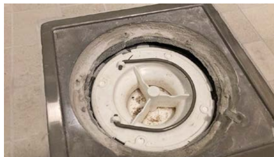
Viser sluk i dusjsonen
